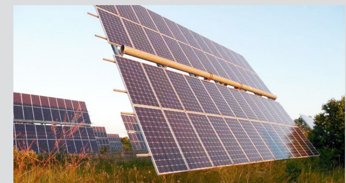
叠瓦组件光伏屋顶电站
