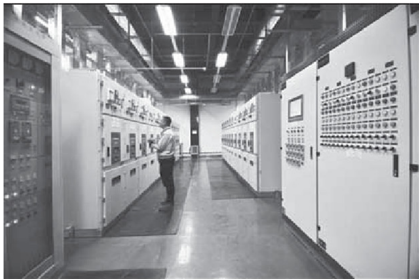
中兴能源华东中心内机房一角
